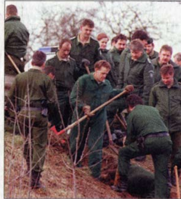
Große Probleme bereitete der Tunnel unter der B 27.
